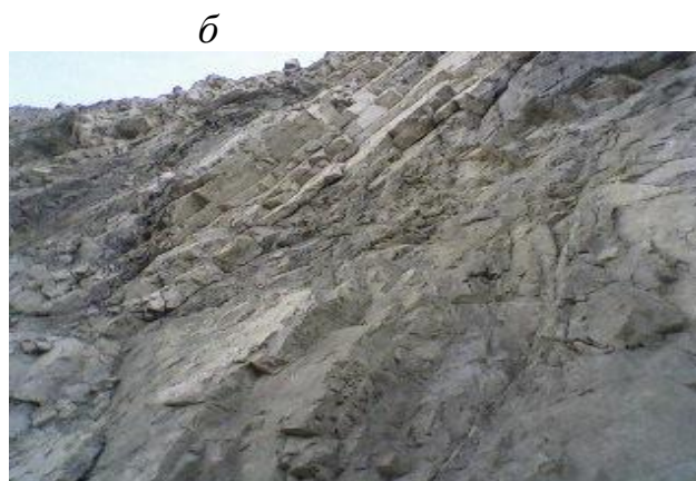
б)- Трещины четвертого блока
